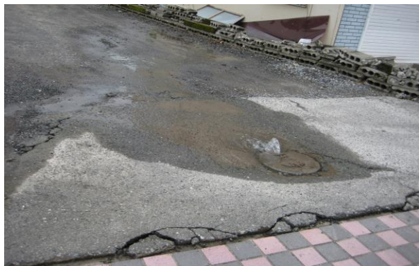
修繕されないまま放置されている水道管からの漏水
