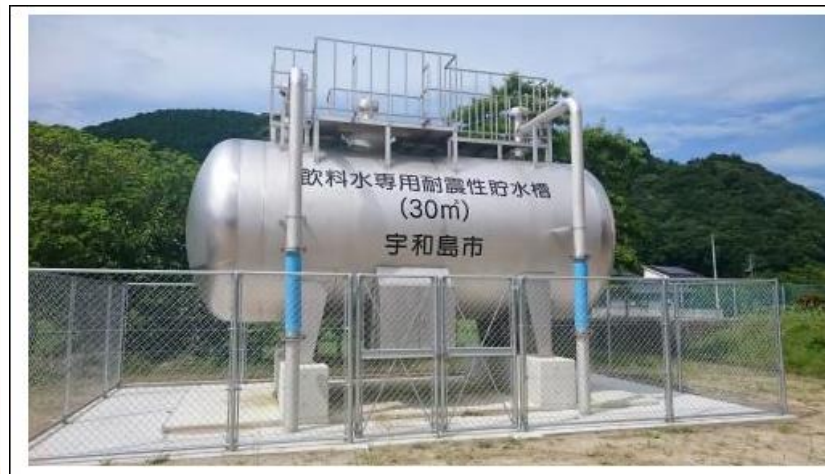
【地上式耐震性貯水槽】 出典：宇和島市HP
